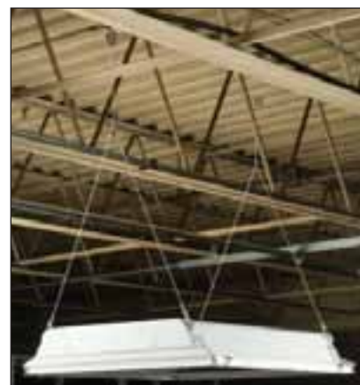
Luminarias tipo High Bay
