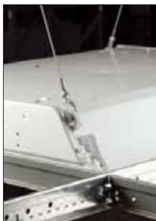
Luminarias en falso plafón (cielo acústico)
